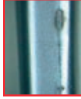
Kontak korozyonu detayı
